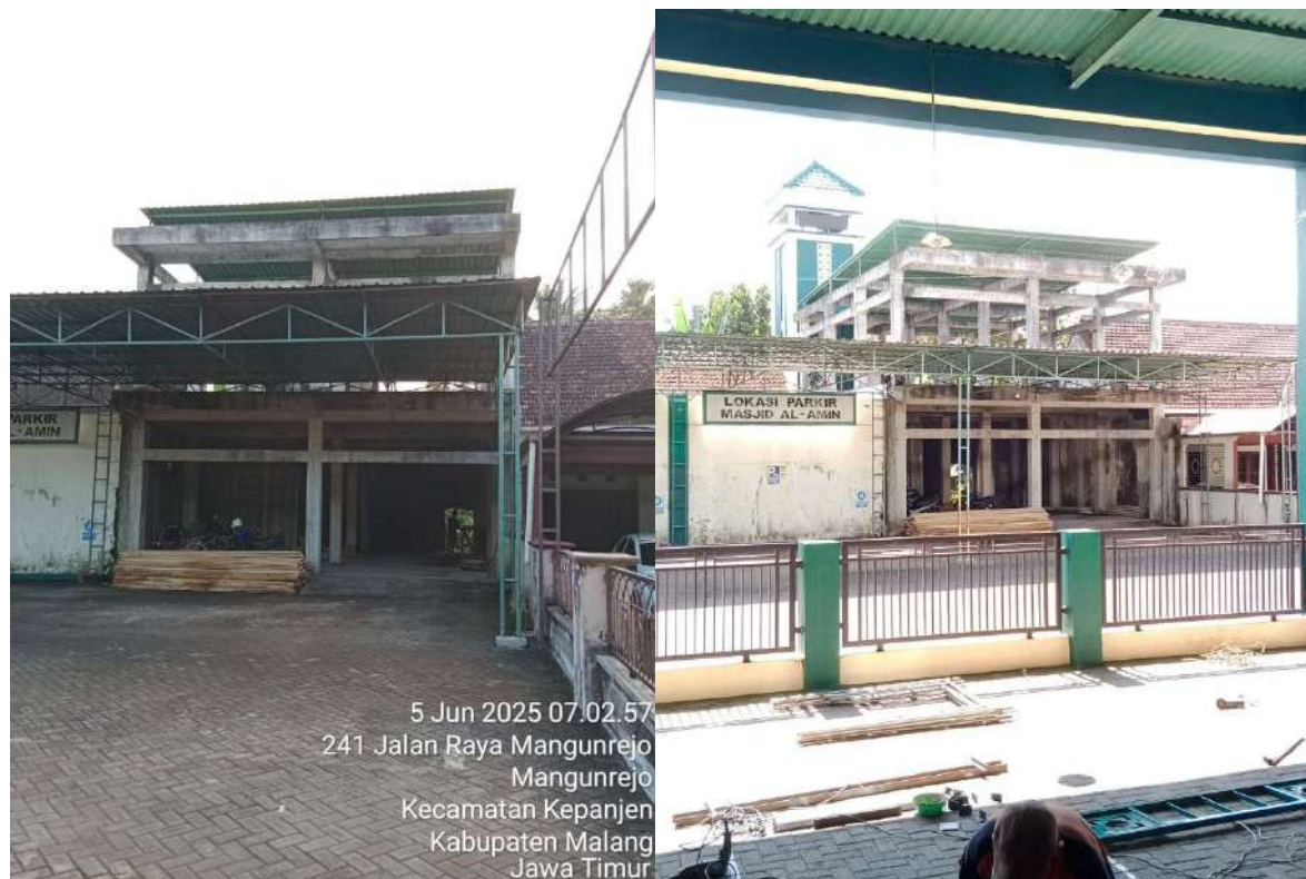
Gambar 4: kondisi bangunan tambahan untuk madrasah diniyyah
