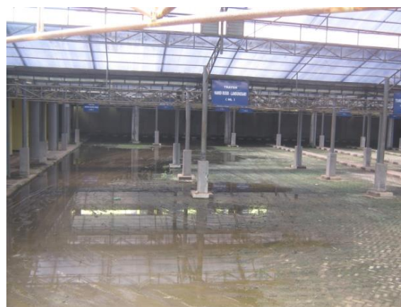
Gambar 5. Banjir akibat kurang tertatanya sistem drainase dengan baik
