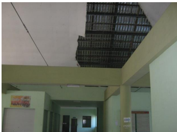
Gambar 6. Kerusakan bangunan terminal mengganggu kenyamanan bagi pengguna
