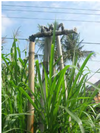
Gambar Pembagian supply air dari pipa menuju tiga sub tandon
